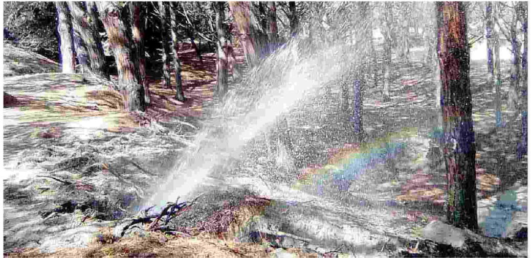
Una delle tante rotture e conseguenti perdite nella pineta di Platamona
