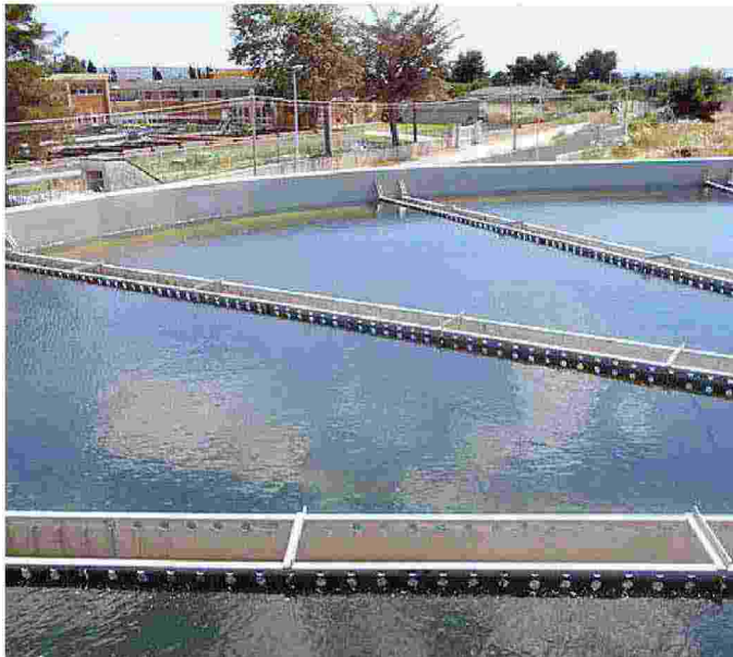
Il potabilizzatore di Truncu Reale a Sassari
