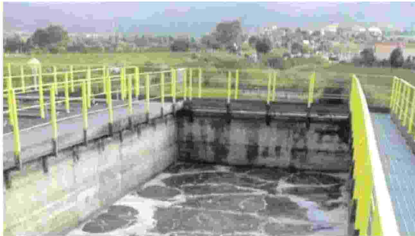
Il depuratore della Bassa Valle del Coghinas
