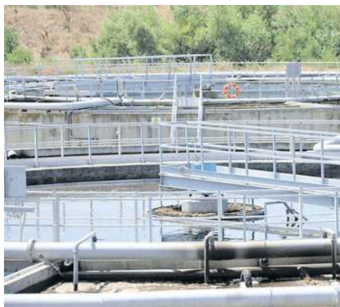
Uno dei depuratori gestiti da Abbanoa
