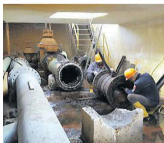
Le vecchie tubazioni
