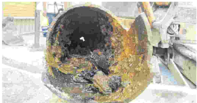
Le condizioni di una vecchia tubatura della rete idrica di Sassari
