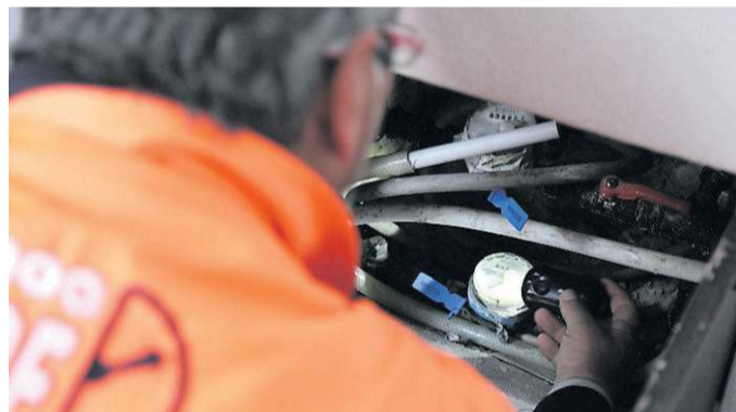
Controlli su un contatore dell'acqua
